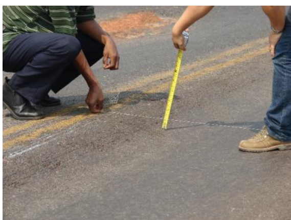
Foto 3 - Aferição da amplitude do afundamento
